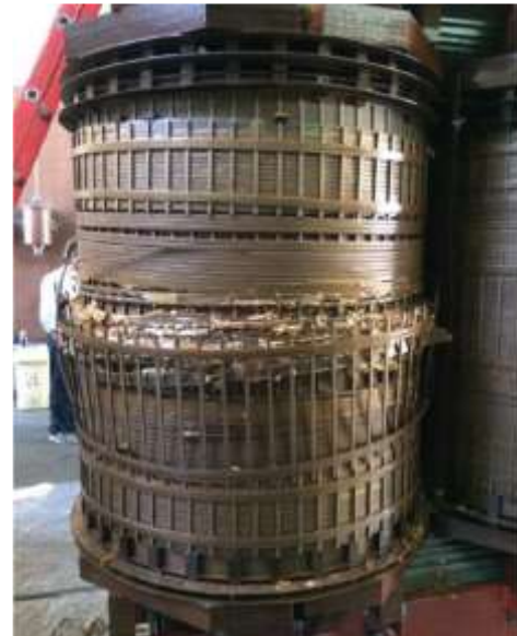
شکل 1: کویل فاز W و محل آسیب‌دیده در قسمت تپ 1 و 2
